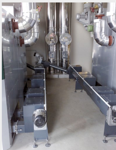
Ilustracja: Odprowadzanie popiołu z kotłów pracujących w kaskadzie.
